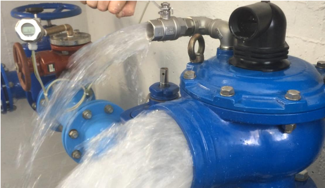
Foto: Austretendes Spülwasser bei geöffnetem Spül-/Entspannungshahn (hier: Typ D-070-DN150)
